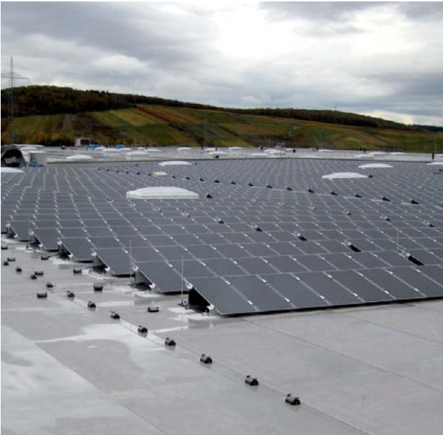
Gewerbehalle, Photovoltaikanlage Flachdach (aufgeständert)
