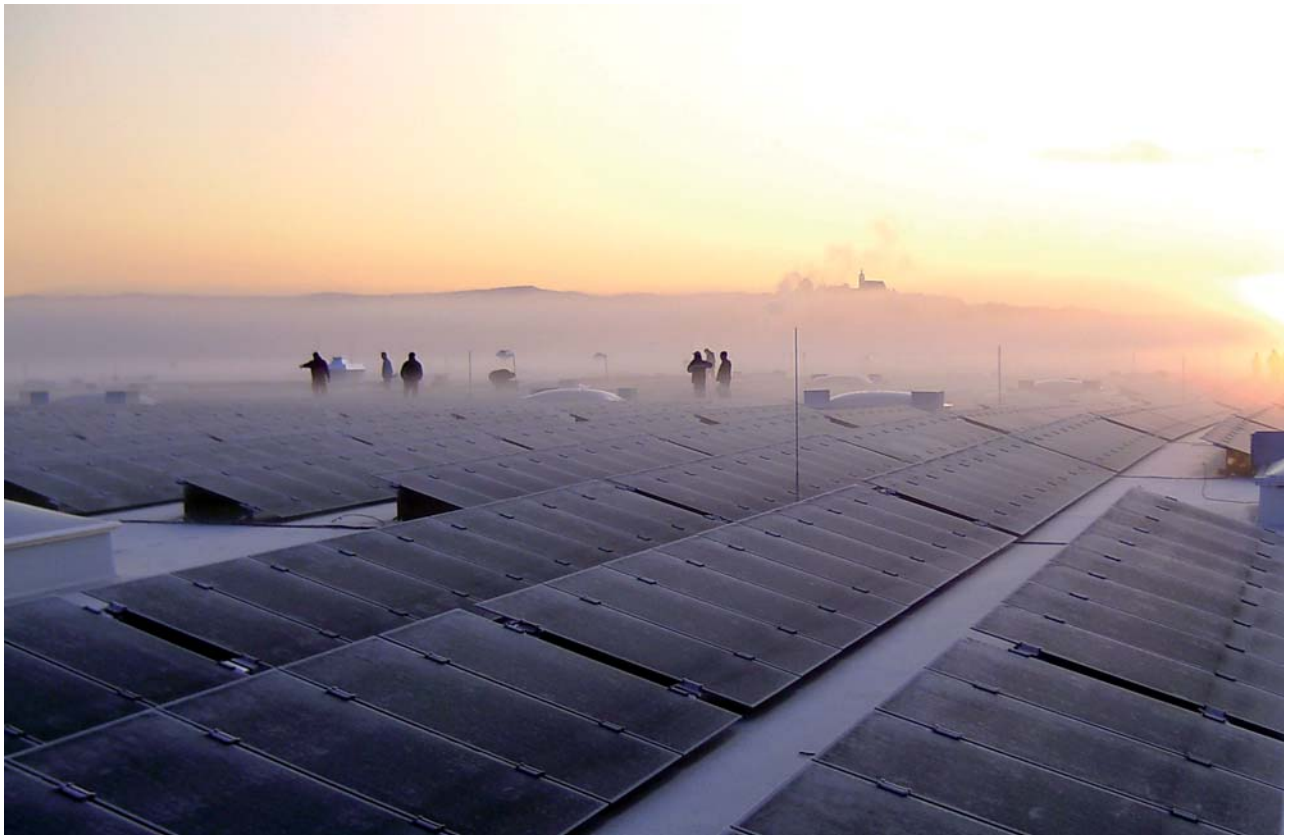
Gewerbehalle, Photovoltaikanlage Flachdach (aufgeständert)
