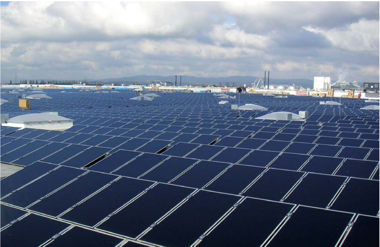
Gewerbehalle, Photovoltaikanlage Flachdach (aufgeständert)
